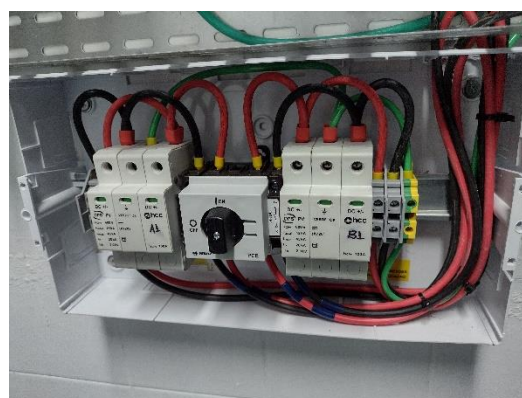
Figura 4 - Imagem da stringbox do inversor 2.
