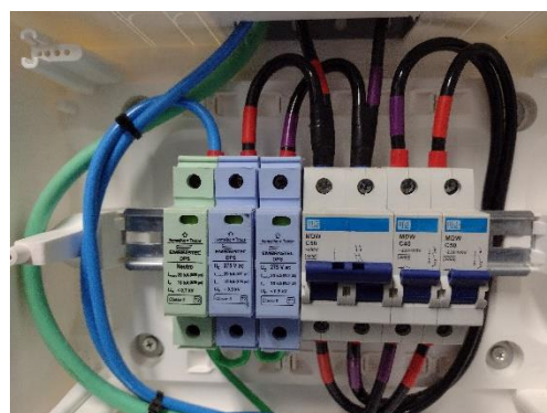
Figura 5 - Imagem dos disjuntores e disjuntor geral.
