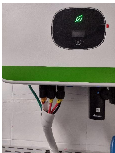
Figura 1 - Imagem do cabeamento da entrada CC do inversor 1.
