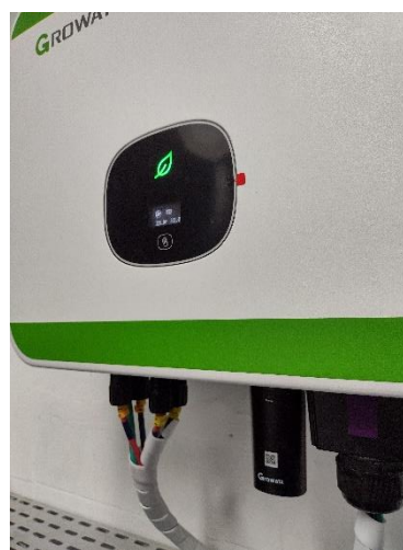
Figura 2 - Imagem do cabeamento da entrada CC do inversor 2.
